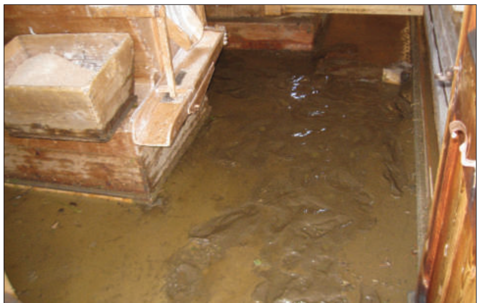
Die Mühle am Wurzerhof wurde außen und innen durch die starke Vermurung in Mitleidschaft gezogen. Durch die tatkräftige Mithilfe vieler konnten die Schäden behoben werden.
