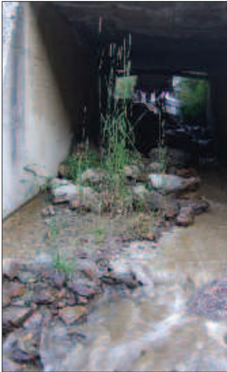
Anhaltende Niederschläge haben den Durchlass Bachlehenbach im Bereich der Winkertalstraße verlegt und musste von den Gemeindefacharbeitern wieder freigelegt werden
