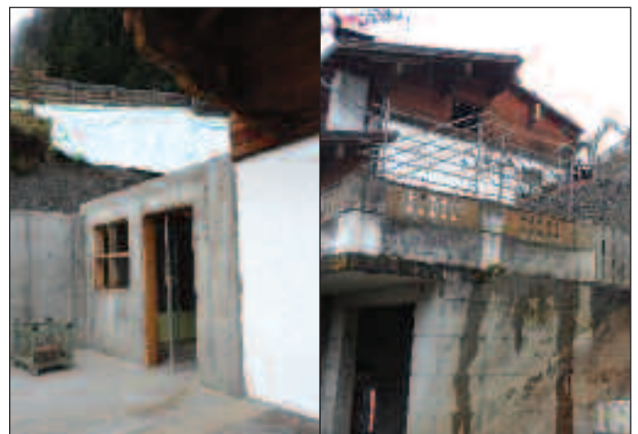
Aufstockung des bestehenden Wohnhauses zur Schaffung einer weiteren Wohneinheit Weitlaner Georg, HNr. 193
