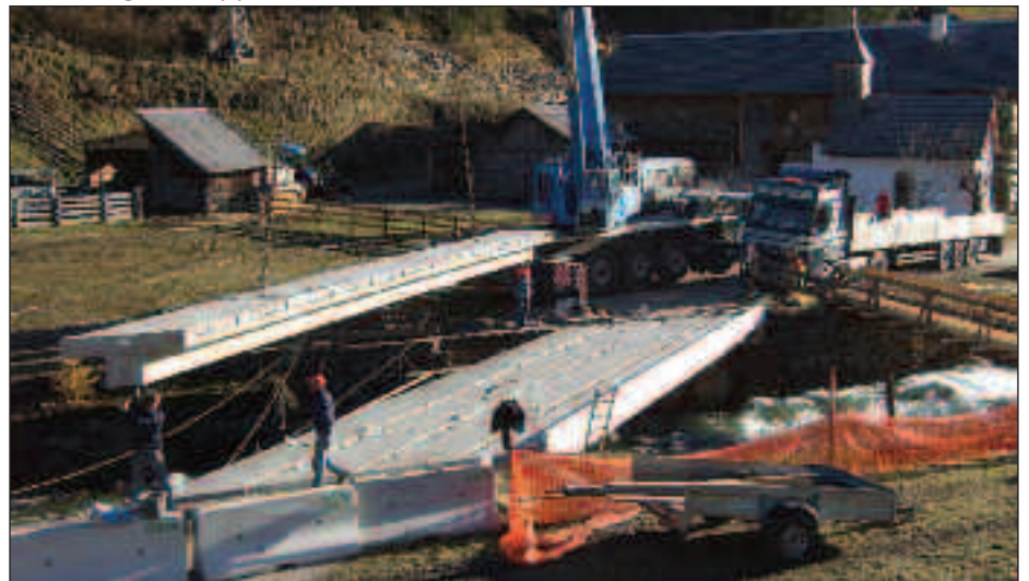
Oben: Fertigung der Betonteile der Wurzerbrücke im Werk Unten: Neubau der Wurzerbrücke
